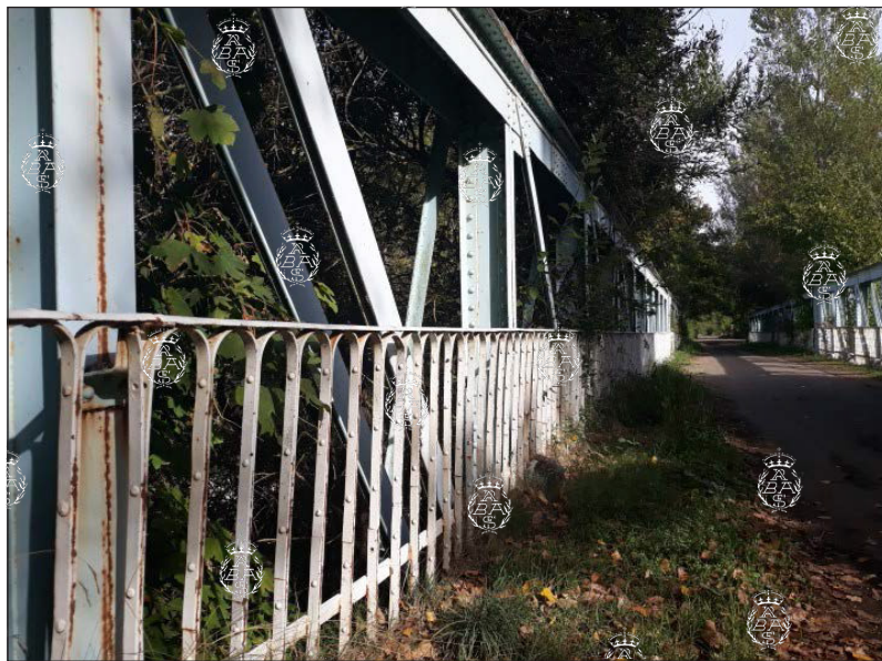
Puente de Arezana, antes de su colapso. Foto: Adolfo Fernández Blanco.
