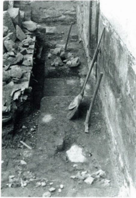
Fig. 12. Cimentaciones aparecidas en las excavaciones.- Corresponden: al primitivo muro del falso crucero, de mayor espesor que el actual; y en la parte baja de la fotografía se aprecia la correspondiente al arco derribado.
