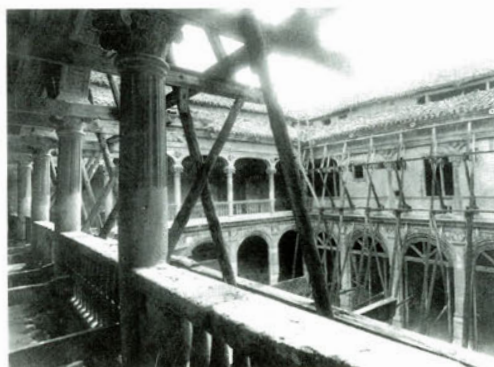
Lám. XI.- El patio, apuntalado desde 1933. Fototeca del Archivo General de la Administración de Alcalá de Henares.
